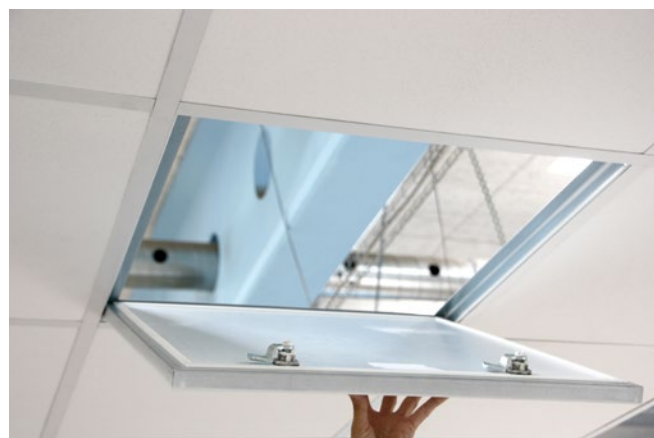
Nem adgang til installationer
